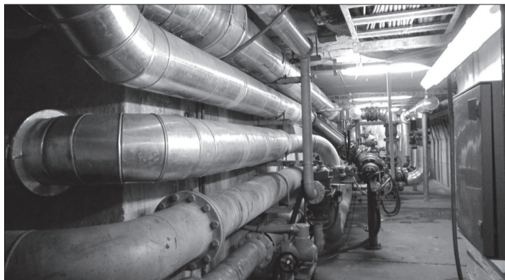
Interno della centrale di Orichella
